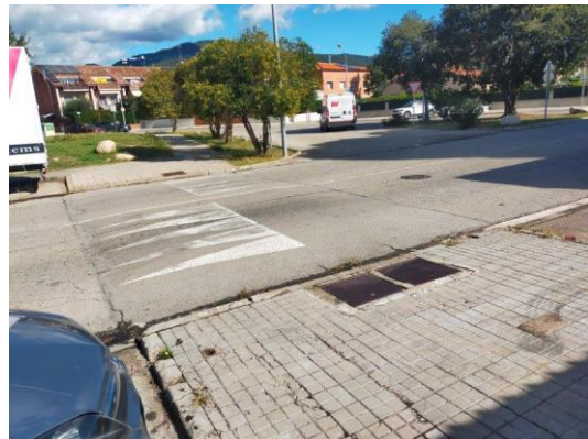
Imatge 66 Intersecció sense pas de vianants adaptat a l'avinguda de la Generalitat.
