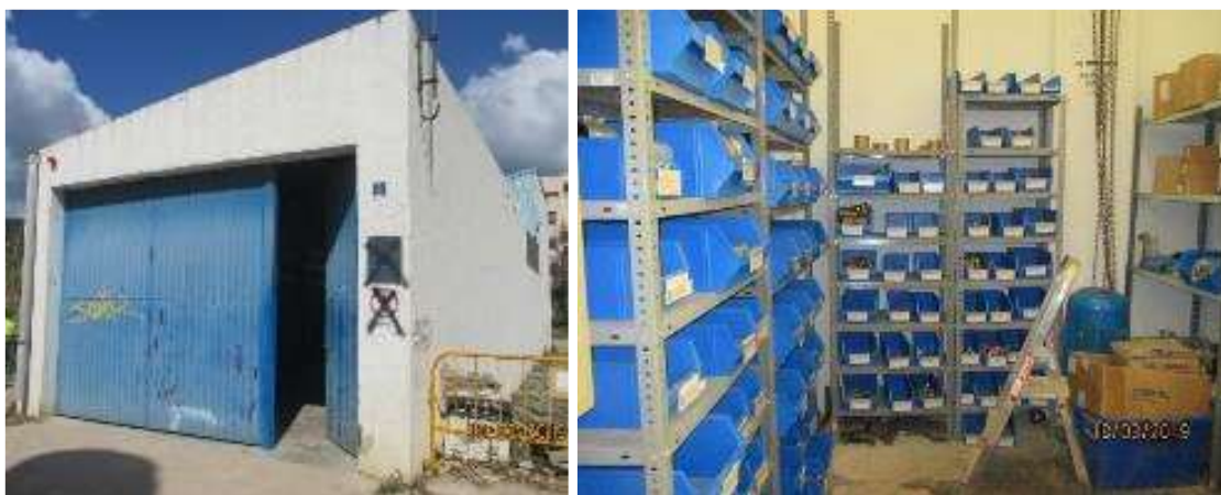
Figura 4. Pou Dyna i magatzem del servei. Exterior, bomba i zona emmagatzematge
