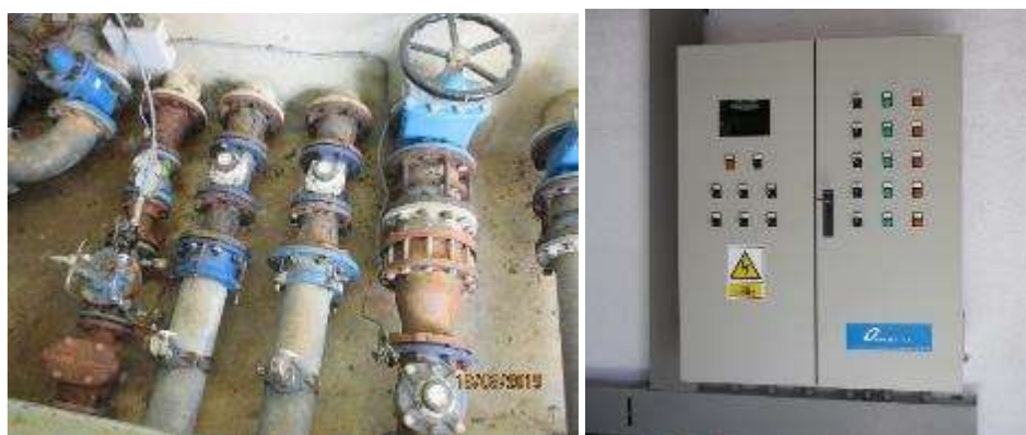
Figura 9. Cambra de claus i telecontrol. Dipòsit La Doma
