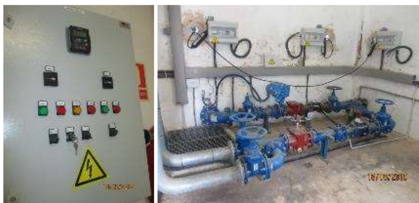
Figura 15. Quadre elèctric del bombeig i telecontrol. Dipòsit Can Tomàs
