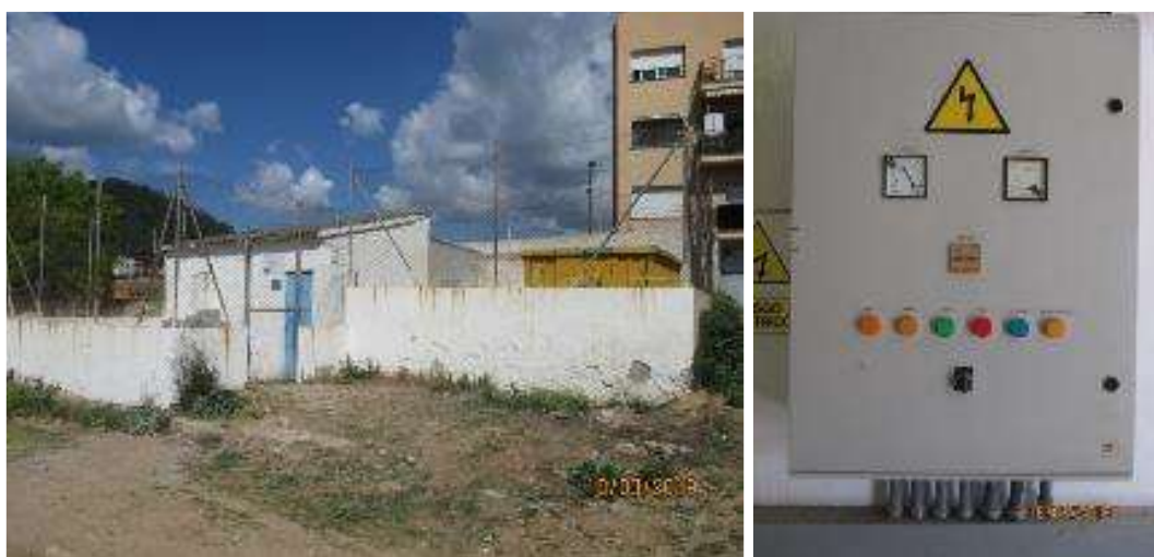
Figura 5. Pou Calderé. Exterior i quadre elèctric
