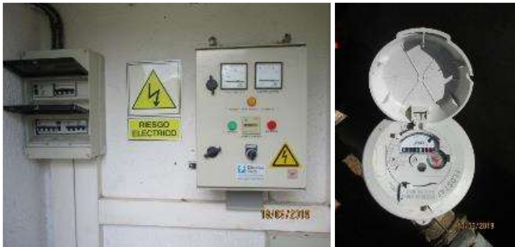
Figura 8. Pou Nou Tremolencs. Quadre elèctric i comptador
