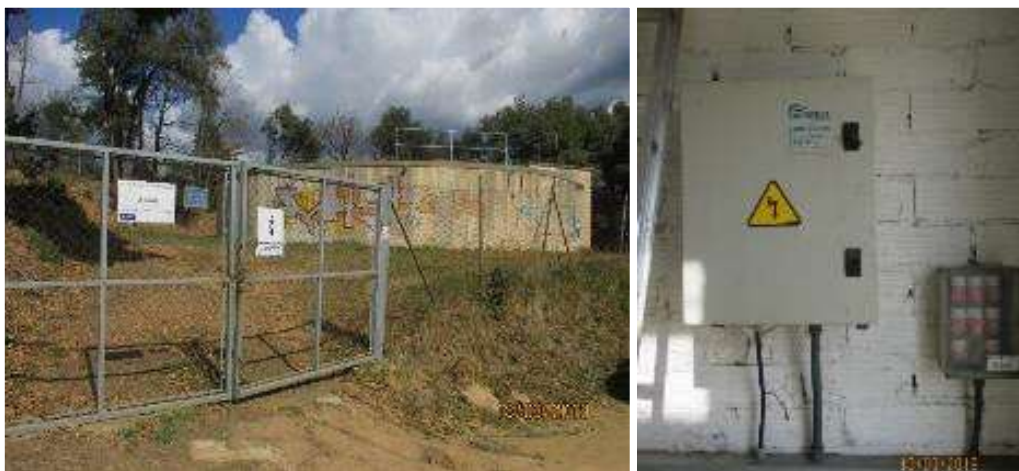
Figura 13. Exterior i telecontrol. Dipòsit Tremolencs 2
